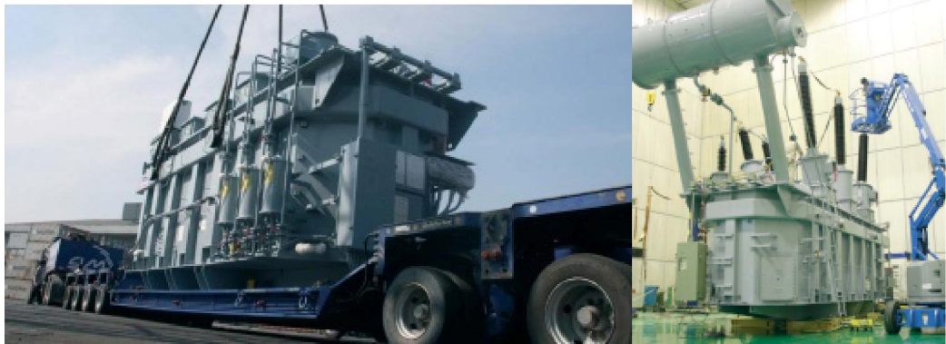
รูปที่ 1-17 แสดงหม้อแปลงแรงดันไฟฟ้า
