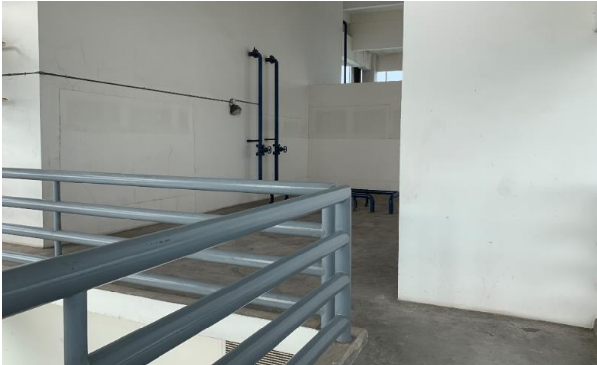
สถานที่ติดตั้ง Inverter และ Battery (ชั้น 18)
